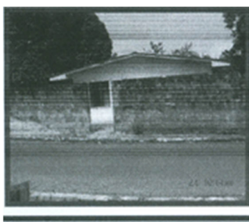
Imagem 3 - RESIDÊNCIA PARA TÉCNICOS / SEDE DO MUNICÍPIO - Detalhes para fachada e muro anterior, sem revestimento e sem portão no vão de acesso ao terreno. O imóvel encontra-se desocupado, sob a responsabilidade da FUNASA no município de São Paulo de Olivença-AM.
