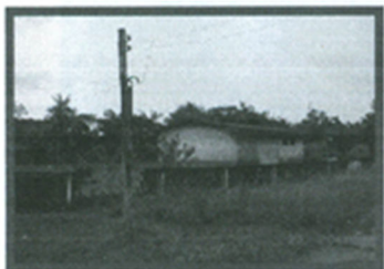
Imagem 1 - POSTO DE SAÚDE / SANTA RITA DO WEILL - Detalhes da elevação lateral, muro danificado e terreno tomado pelo capim do Posto de Saúde sob a responsabilidade do Município de São Paulo de Olivença-AM.
