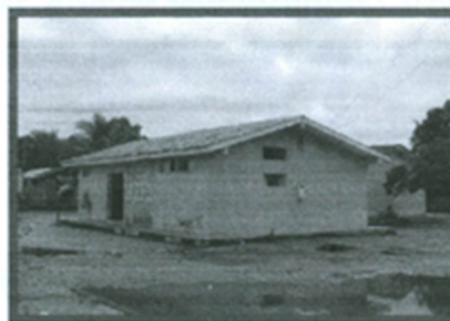
Imagem 6 - POSTO DE SAÚDE I SÃO FRANCISCO DO TONANTINS - Elevação lateral do Posto que atende a população residente na comunidade no município de Tonantins-AM, em situação ruim. Cedido ao município desde/99.
