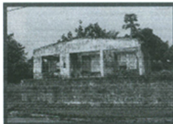
Imagem 2 - RESIDÊNCIA PARA TÉCNICOS / SEDE DO MUNICÍPIO - Detalhes para fachada e muro anterior edificação totalmente danificada, terreno tomado pela vegetação, sob a responsabilidade da FUNASA no município de São Paulo de Olivença-AM.
