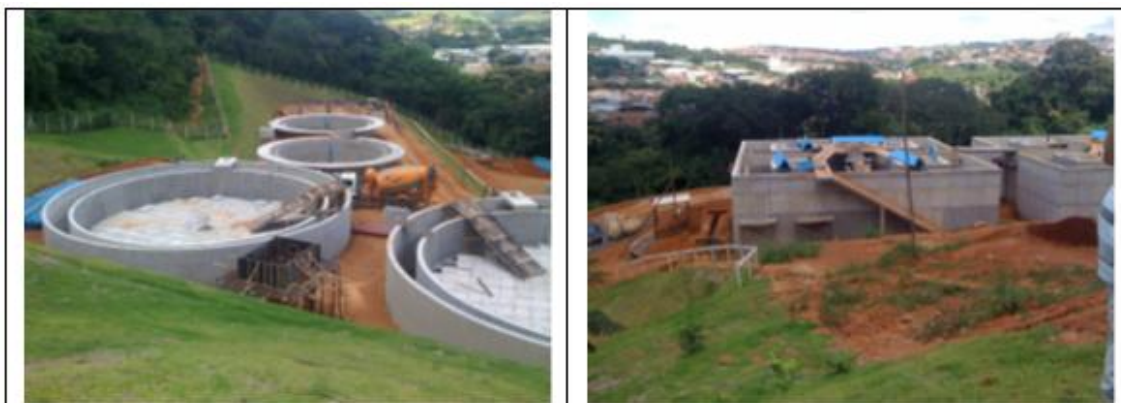
Figura 1: Fotos da Estação de Tratamento de Esgotos, Município de Machado/MG, TC/PAC 0001/2012 (R$ 15.424.979,09), obra com 63,4% de execução física. Fonte SIGOB.
