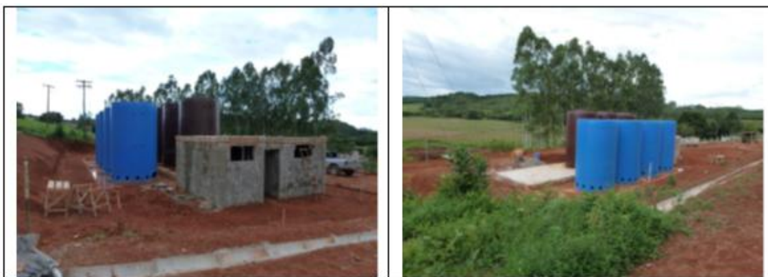
Figura 2: Fotos da Estação de Tratamento de Esgoto, Município de Carvalhopolis/MG, TC/PAC 0100/2012 (R$ 2.221.965,63), obra com 72,6% de execução física. Fonte SIGOB.
