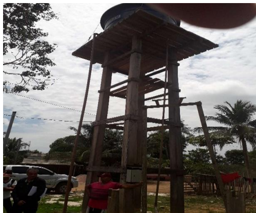
Figura 1: Município de Belterra / Comunidade do Alemão - Reservação
