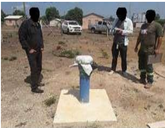
Figura 3 – Município de Belterra/Rua Socorro Nunes com Henry Ford – Poço sem o devido tamponamento.
