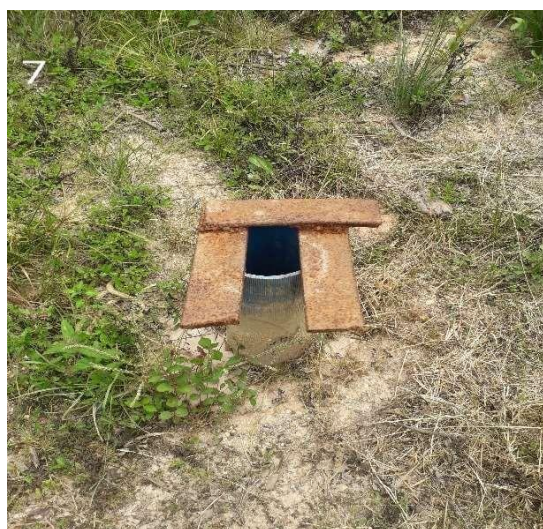
Figura 5: Município de Belterra / Comunidade Cinquenta e Sete – Poço profundo tubular aberto
