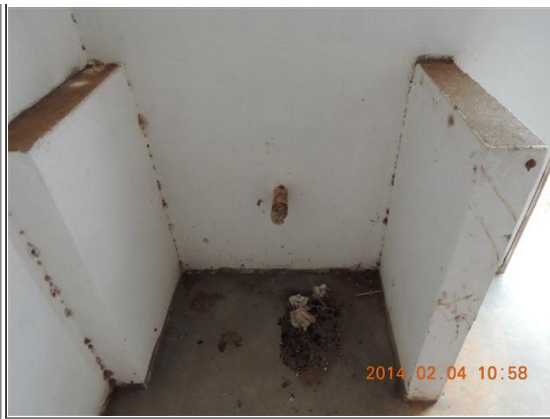
Foto 3 - Unidades Habitacionais - Obra Incacabada - 04/02/14
