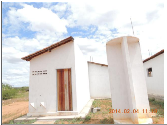
Foto 4 - Unidades Habitacionais - Obra Incacabada - 04/02/14
