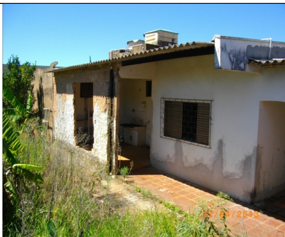
Parede da lavanderia do imóvel demolida pela empresa executora do contrato nº 22/2010, sem autorização do proprietário.
