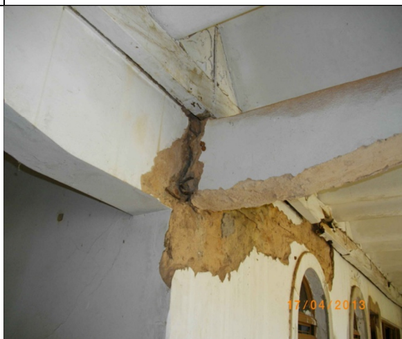
Intervenção realizada na viga de sustentação da cobertura da varanda (contrato nº 22/2010), sem autorização do proprietário, comprometendo a estrutura do imóvel.
