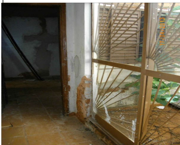
Porta de vidro do jardim de inverno, sem vidro e parede do corredor de acesso sem reboco.
