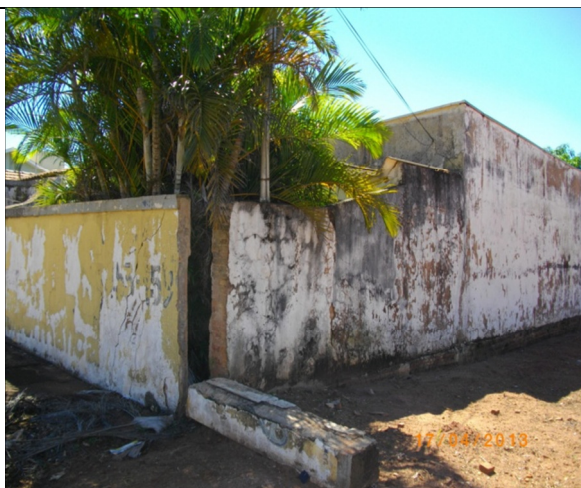
Coluna do muro derrubada, colocando em risco a estrutura de alvenaria.
