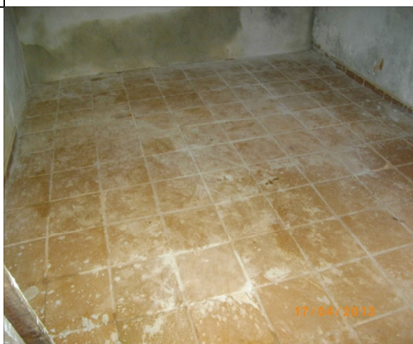
Piso cerâmico de um dos três quartos do imóvel todo manchado com massa de cimento, em virtude dos serviços de reboco executados por meio do contrato nº 22/2010.
