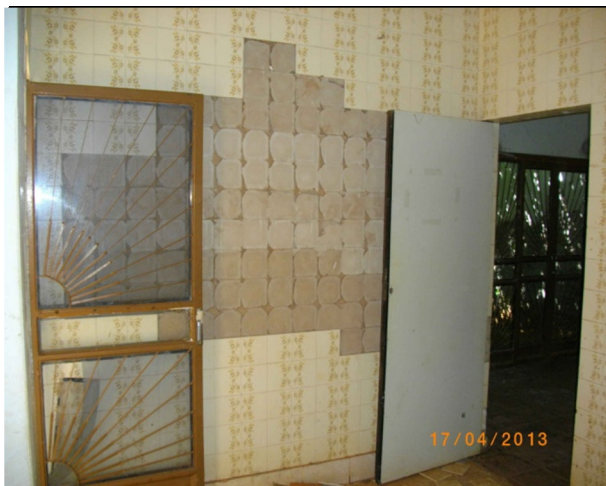
Parede da cozinha do imóvel com alguns revestimentos retirados.
