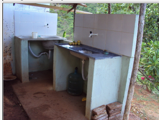
Beneficiário nº 14 – tanque de lavar roupas executado sem a cobertura com telha e dimensões divergente do projeto
