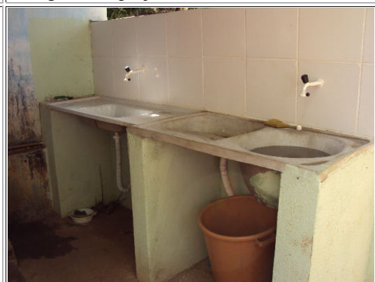
Beneficiário nº 15 - tanque de lavar roupas sem a cobertura com telha e dimensões divergentes do projeto
