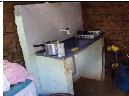
Beneficiário nº 01 Aldeia Cafurna de Baixo – pia de cozinha executada em casa de taipa
