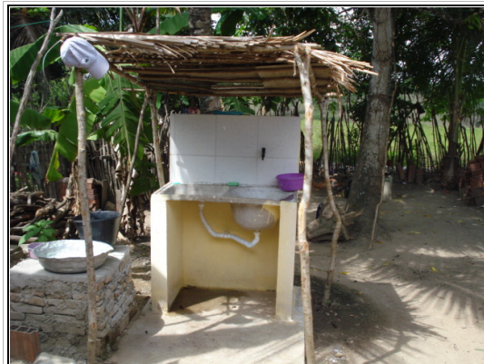
Beneficiário nº 26 Aldeia Tingui-Botó – Tanque de lavar roupa executado não construído sobre parede existente
