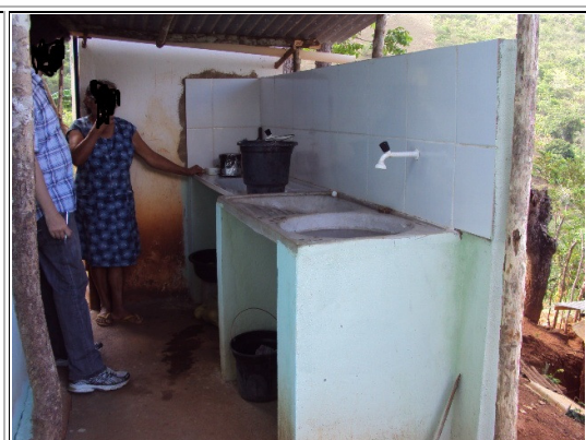
Beneficiário nº 13 – tanque de lavar roupas executado sem a cobertura com telha e dimensões divergente do projeto
