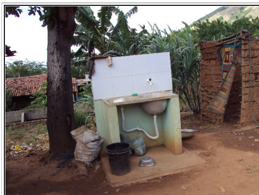
Beneficiário nº 01 – tanque de lavar roupas executado sem a cobertura com telha e dimensões divergente do projeto
