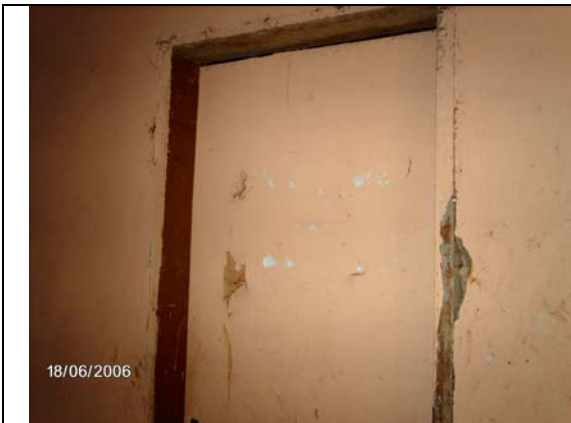
Rachaduras nas paredes
