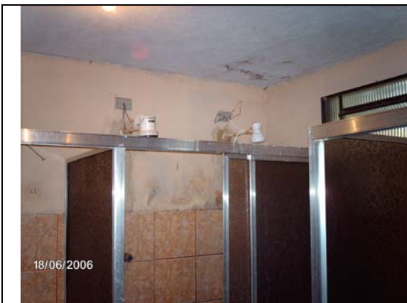
Paredes com infiltração
