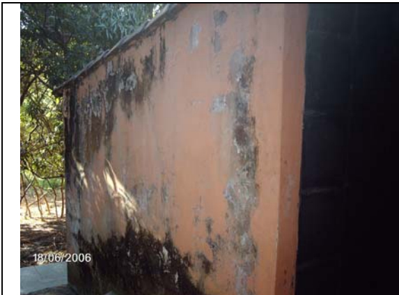
Paredes com infiltração
