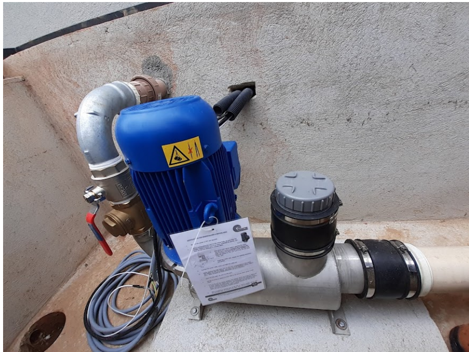
Condomínio - Soleira Negativa
