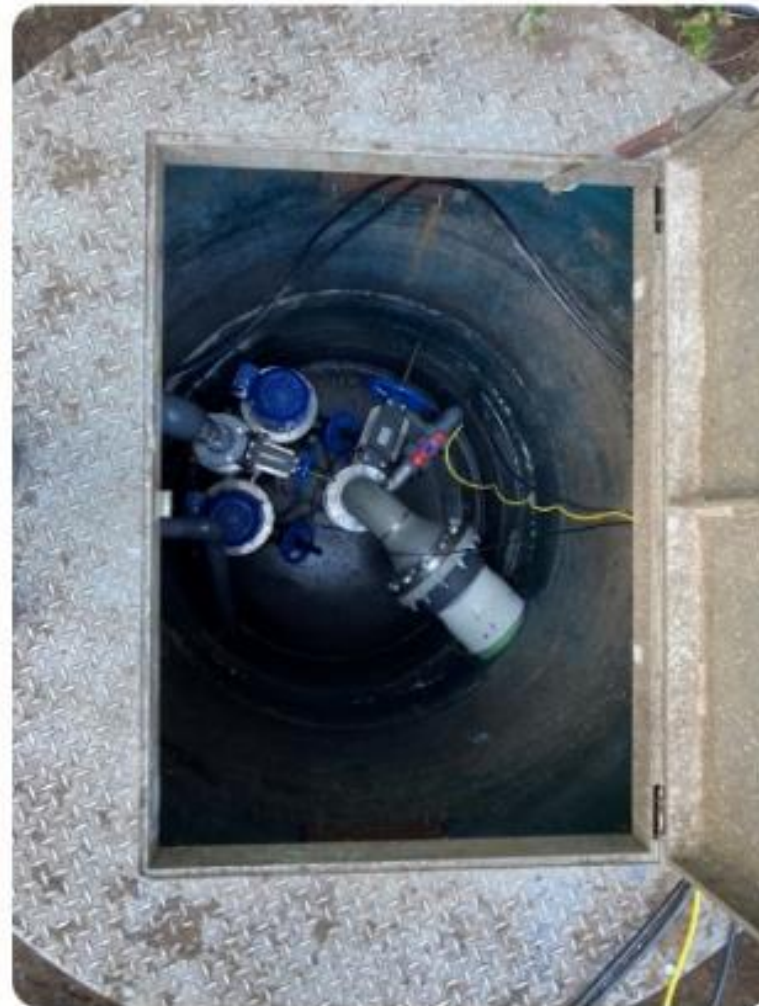
Instalação com Booster de esgoto
